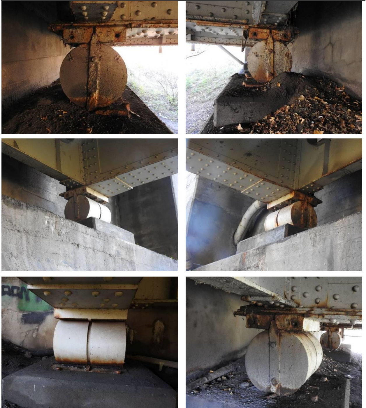
Fot. 3.29. Przykładowe fotografie przedstawiające stan techniczny wałkowych łożysk ruchomych na przyczółku – widoczne intensywne ubytki powłok antykorozyjnych, zwłaszcza płyt górnych i wałków łożysk ruchomych wraz z towarzyszącą im korozją powierzchniową, lokalne zanieczyszczenia smarem tocznym oraz zanieczyszczenia ziemne i organiczne w obrębie ciosów.
