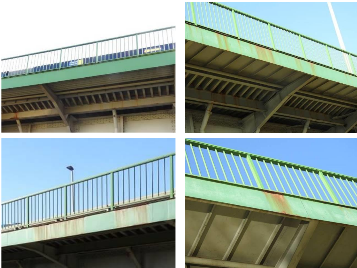
Fot. 3.8. Przykładowe fotografie przedstawiające stan techniczny gzysów.
