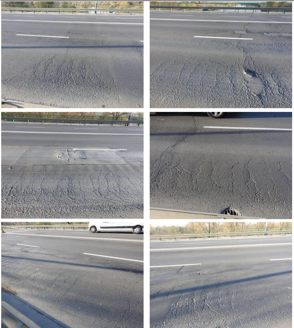
Fot. 3.4. Przykładowe fotografie przedstawiające stan techniczny nawierzchni drogowej na obiekcie – widoczne liczne spękania bitumicznej nawierzchni jezdni, deformacje nawierzchni w postaci podłużnych kolein, lokalne braki wypełnienia masą zalewową szczelin na łączeniach napraw i nawierzchni, ślady po wykonanych naprawach, lokalne ubytki asfaltu (wykruszenia) w obrębie spękań i napraw oraz miejscowe zanieczyszczenia materiałem ziemnym w obrębie stref przy krawężnikach.
