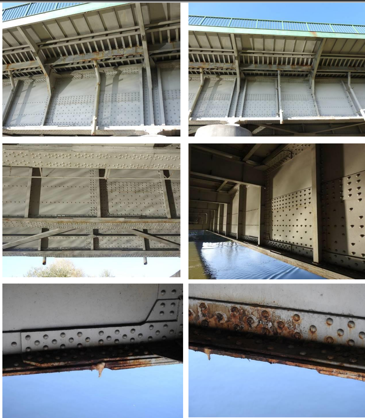
Fot. 3.21. Przykładowe fotografie przedstawiające stan techniczny ustroju nośnego mostu – widoczne ubytki powłok antykorozyjnych wraz z towarzyszącą im korozją powierzchniową występującą głównie na pasach dolnych dźwigarów głównych oraz rdzawe zanieczyszczenia i zacieki na środnikach poprzecznic.
