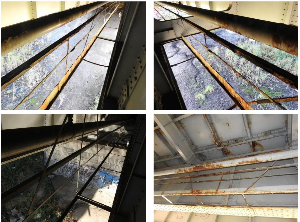
Fot. 3.38. Przykładowe fotografie przedstawiające stan techniczny pomostu technologicznego pod przęsłem.
