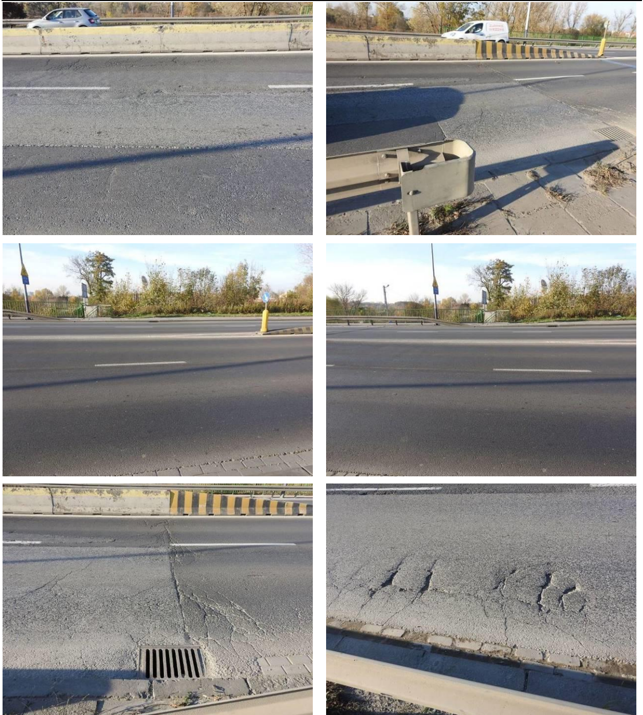
Fot. 3.2. Przykładowe fotografie przedstawiające stan techniczny nawierzchni jezdni na dojazdach – widoczne deformacje nawierzchni jezdni w postaci skoleinowania, wegetacja roślinności oraz nieznaczne zanieczyszczenia stref przykrawężnikowych materiałem ziemnym, spękania nawierzchni bitumicznej oraz lokalne ubytki asfaltu i ślady napraw.
