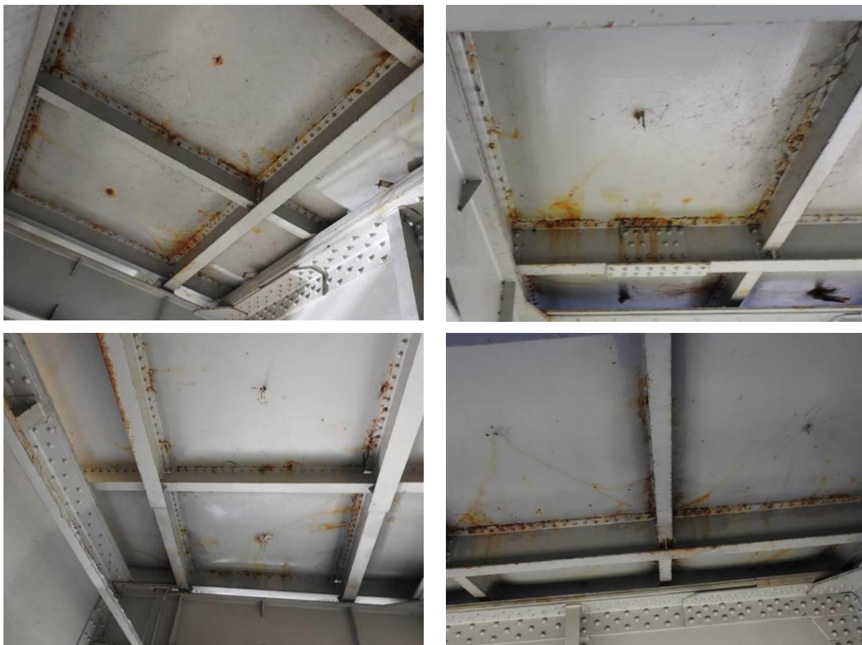
Fot. 3.17. Przykładowe fotografie przedstawiające stan techniczny pomostu – widoczne obszary uszkodzeń powłok antykorozyjnych z towarzyszącą im korozją powierzchniową.
