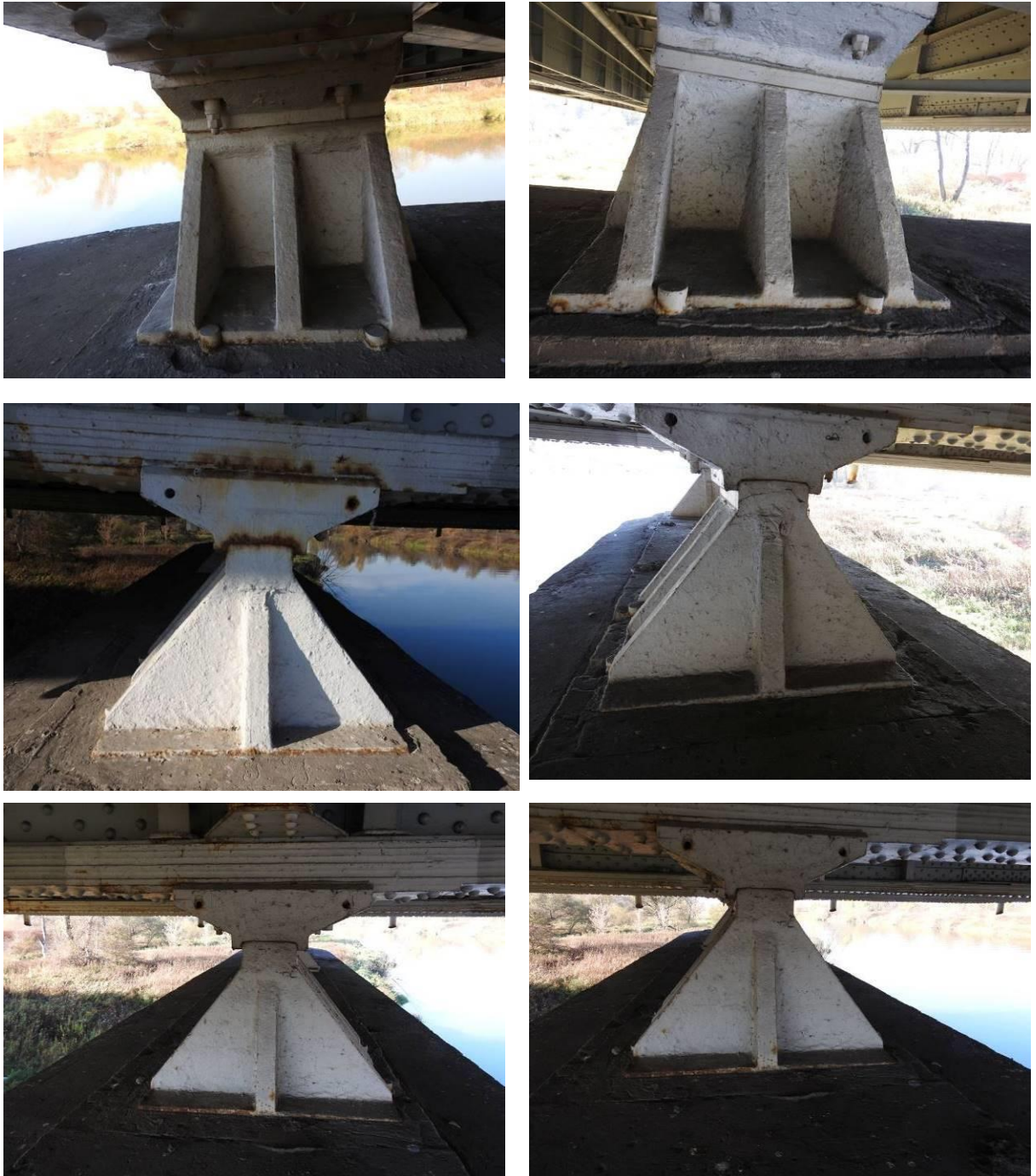
Fot. 3.26. Przykładowe fotografie przedstawiające stan techniczny łożysk stałych znajdujących się na lewobrzeżnym filarze nurtowym – niewielkie ogniska korozji wżerowej w miejscu posadowienia łożyska na filarze.
