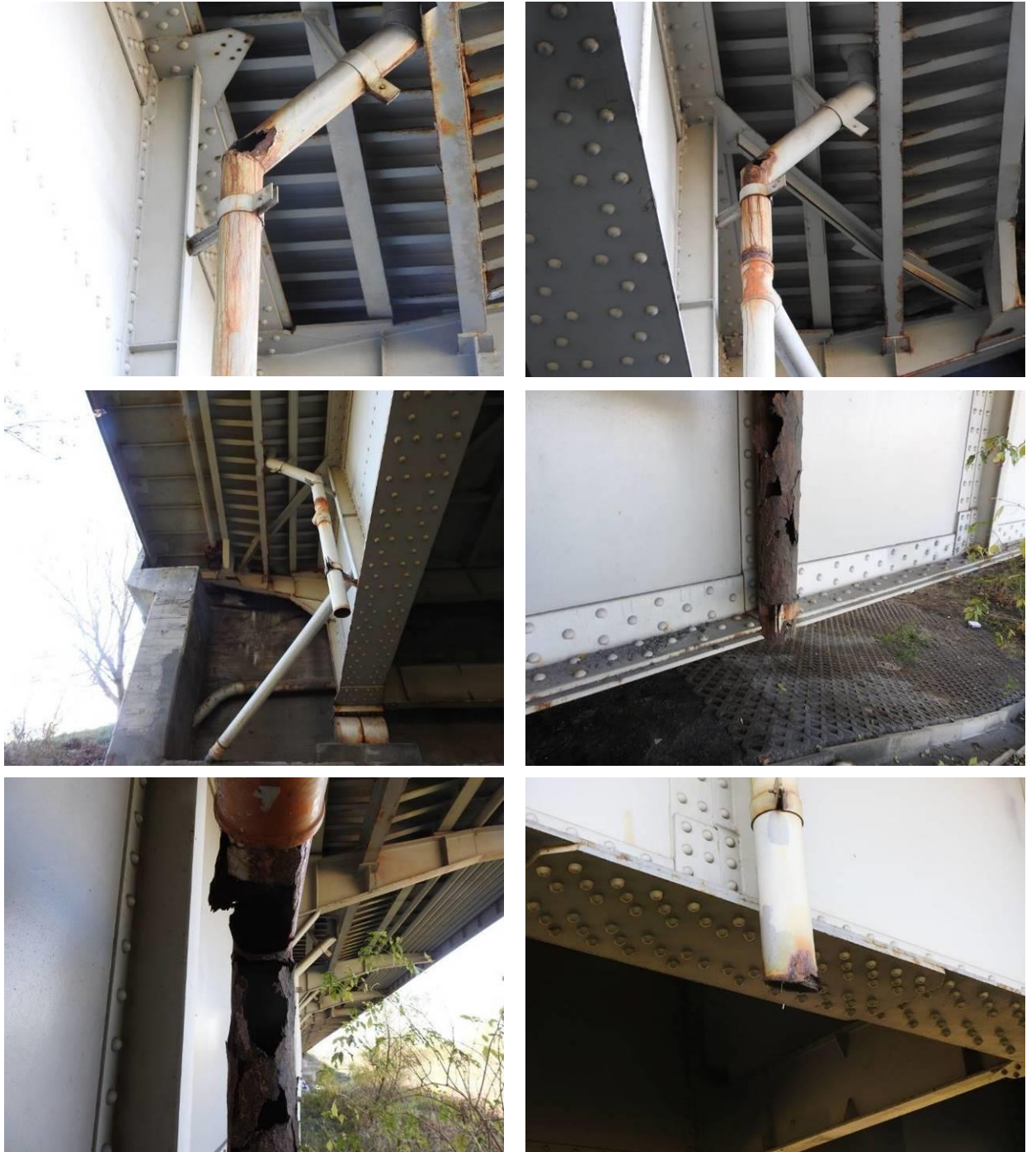
Fot. 3.13. Przykładowe fotografie przedstawiające stan techniczny urządzeń odwadniających – widoczne stalowe elementy wpustów mostowych, kielichy, uległy znacznej degradacji korozyjnej oraz lokalnej perforacji.
