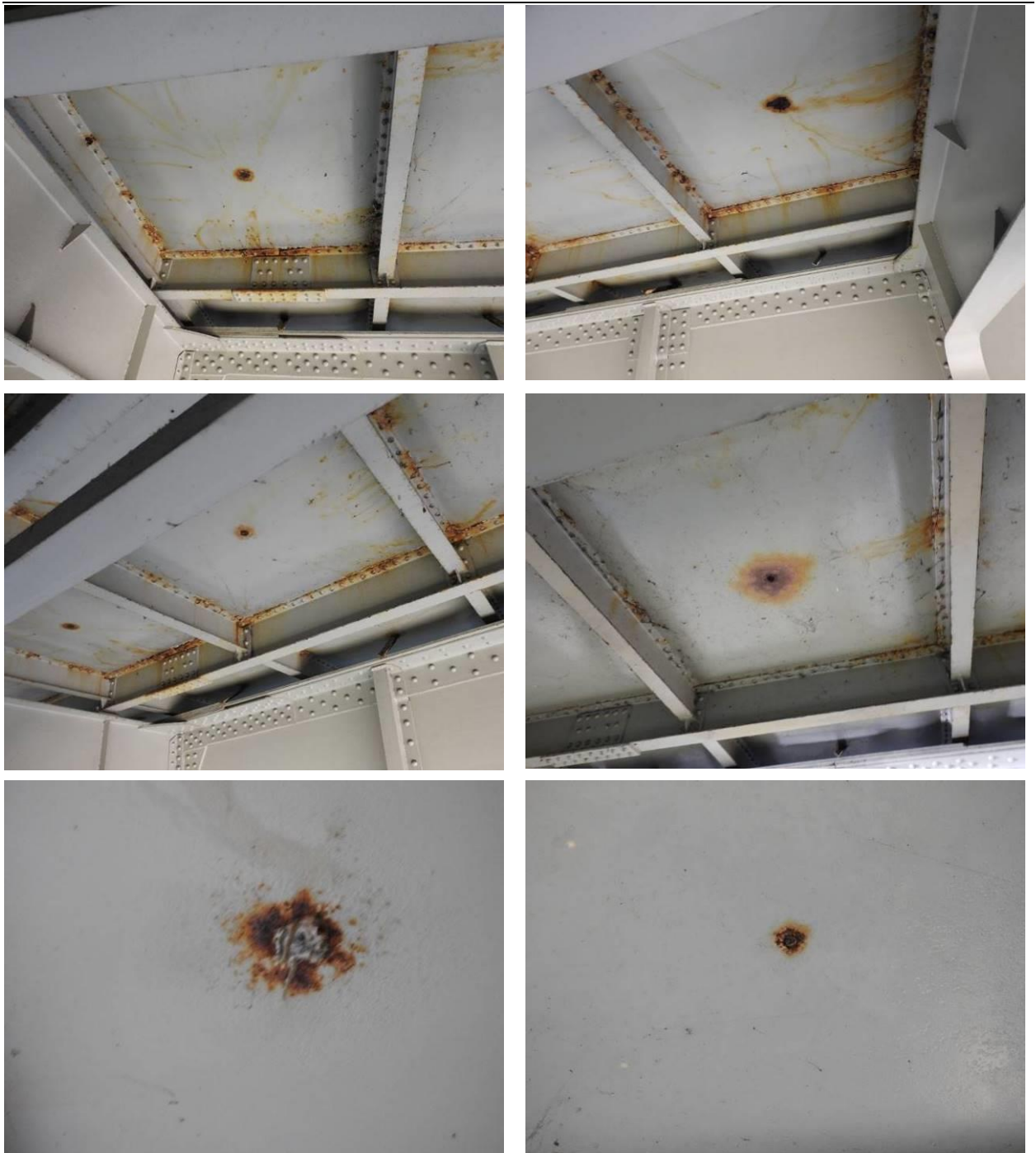
Fot. 3.14. Przykładowe fotografie przedstawiające stan techniczny urządzeń odwadniających – brak rur odpływowych z blach nieckowych powoduje zacieki oraz procesy korozyjne blach nieckowych.
