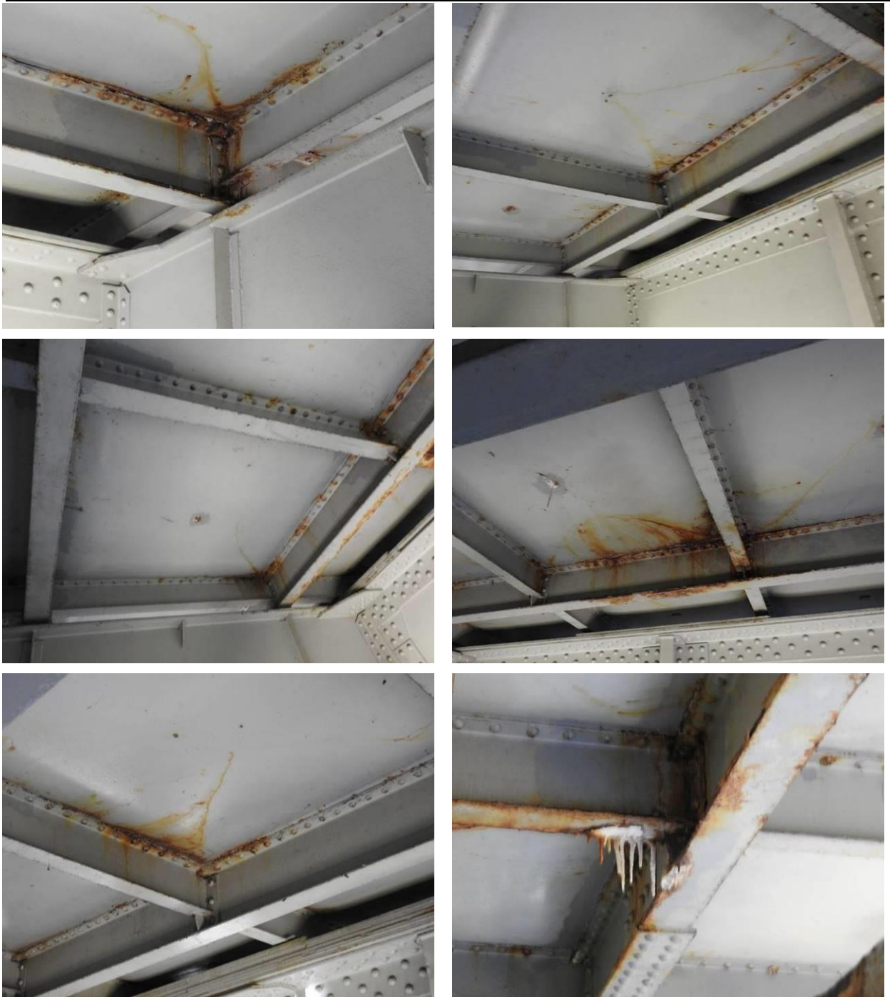
Fot. 3.18. Przykładowe fotografie przedstawiające stan techniczny pomostu – widoczne obszary uszkodzeń powłok antykorozyjnych z towarzyszącą im korozją powierzchniową, licznie występujące rdzawe zacieki, obszary zawilgoceń na powierzchniach blach nieckowych oraz przecieki i białe wykwity (w postaci stalaktytów) na spodzie belek pomostu.
