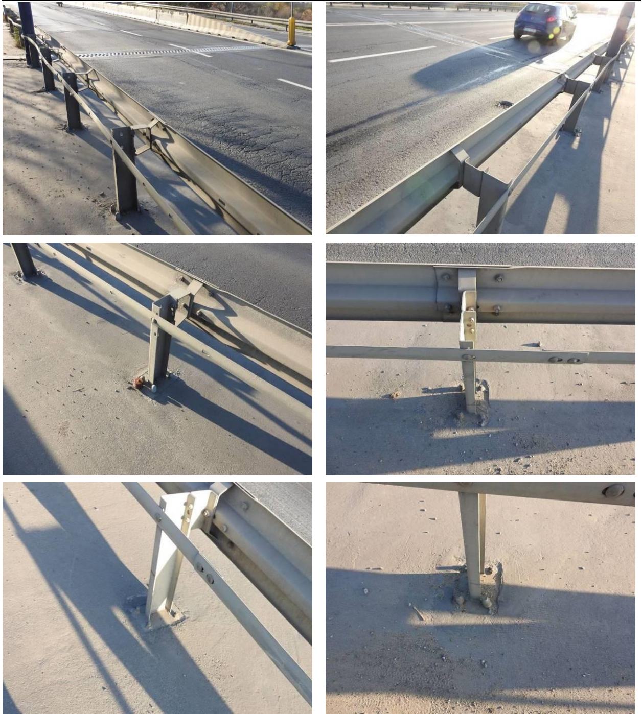
Fot. 3.11. Przykładowe fotografie przedstawiające stan techniczny barier energochłonnej na obiekcie – widoczne deformacje i zanieczyszczenia nawierzchni bitumicznej w miejscu kotwienia słupków bariery energochłonnej.
