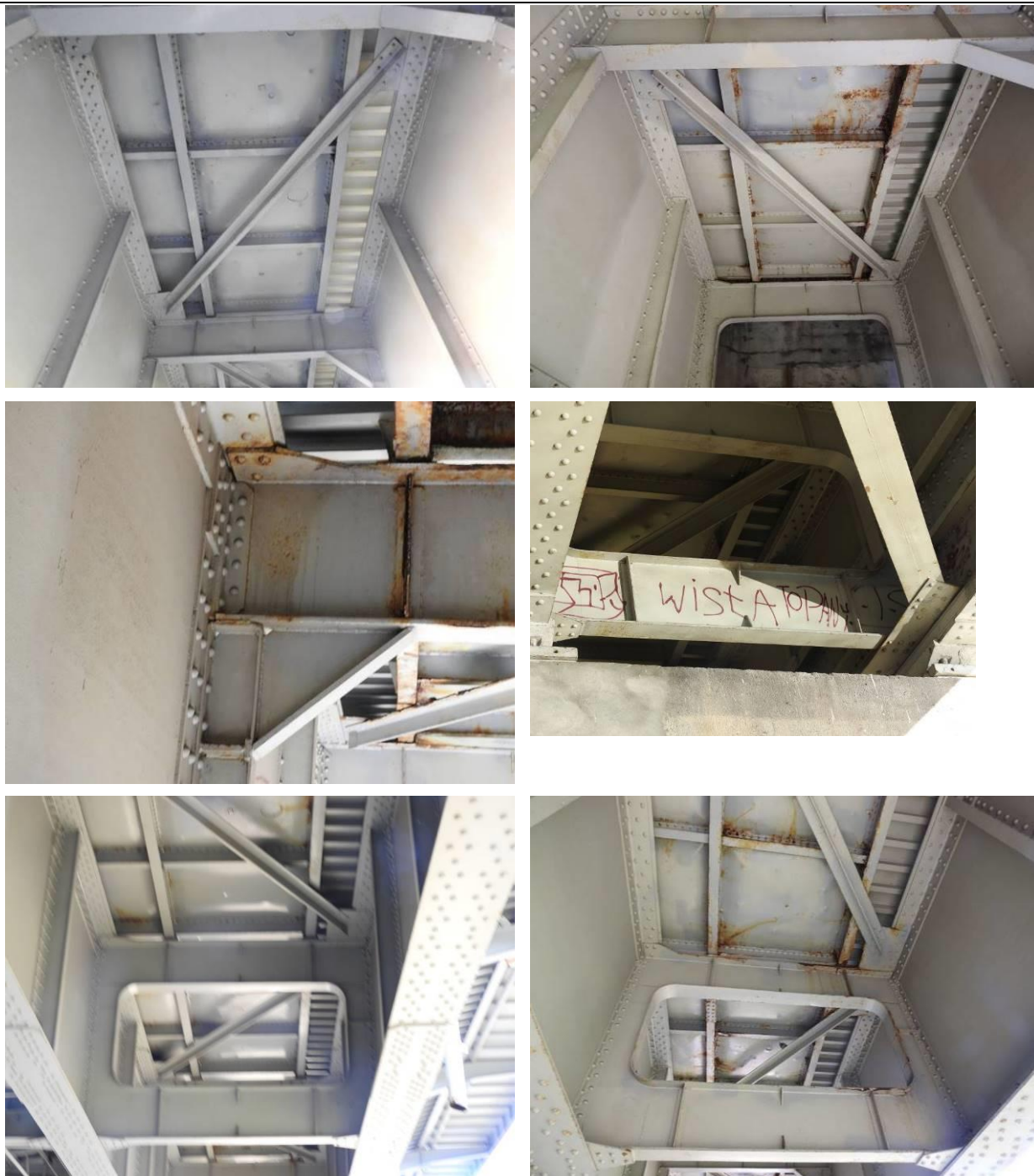
Fot. 3.22. Przykładowe fotografie przedstawiające stan techniczny ustroju nośnego mostu – widoczne ubytki powłok antykorozyjnych wraz z towarzyszącą im korozją powierzchniową występującą głównie na pasach dolnych dźwigarów głównych oraz rdzawe zanieczyszczenia i zacieki na środnikach poprzecznic.
