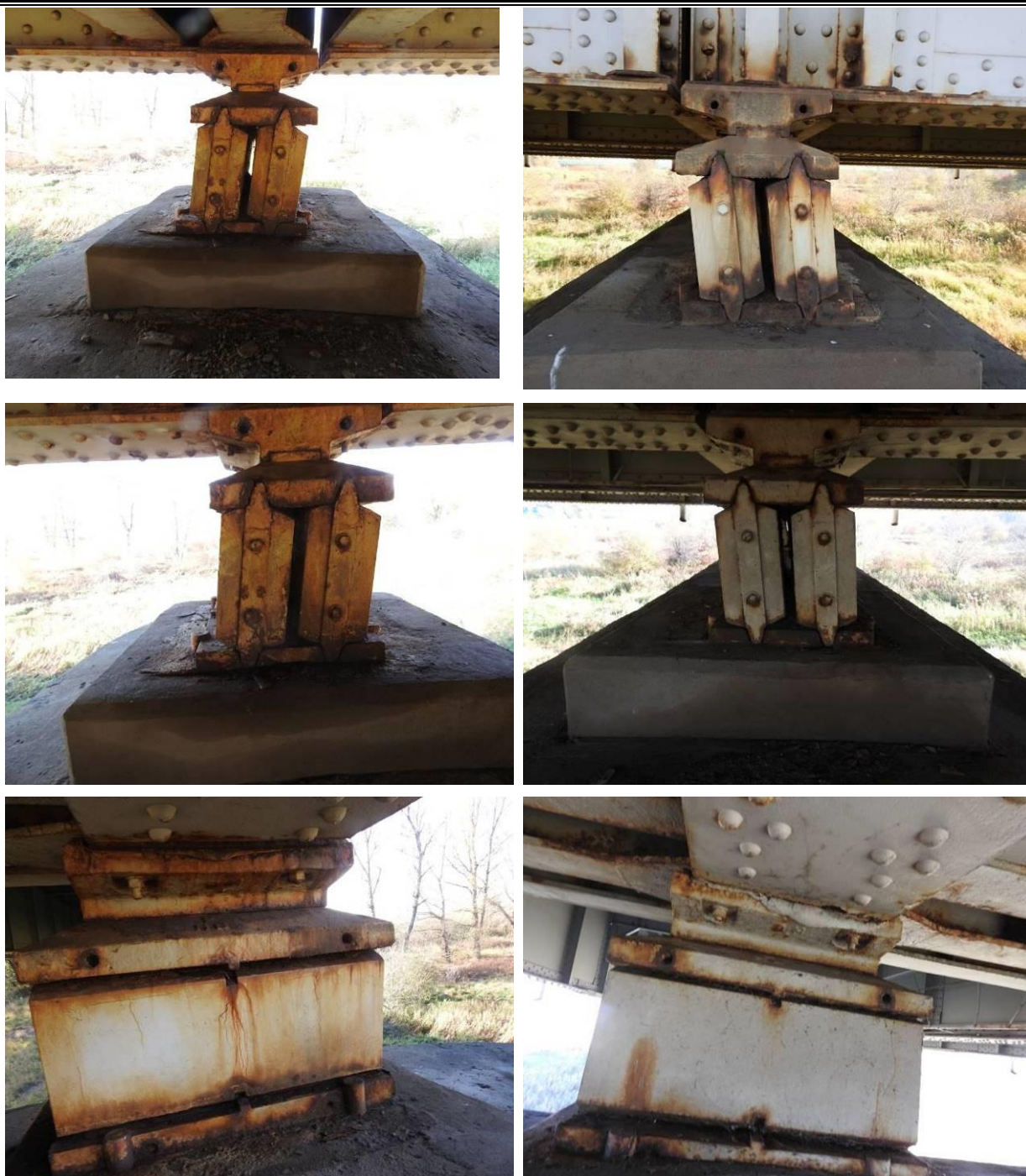
Fot. 3.28. Przykładowe fotografie przedstawiające stan techniczny ustroju nośnego mostu – widoczne odchylenie od pionu ruchomych łożysk dwupiętrowych oraz intensywne ogniska korozji powierzchniowej.
