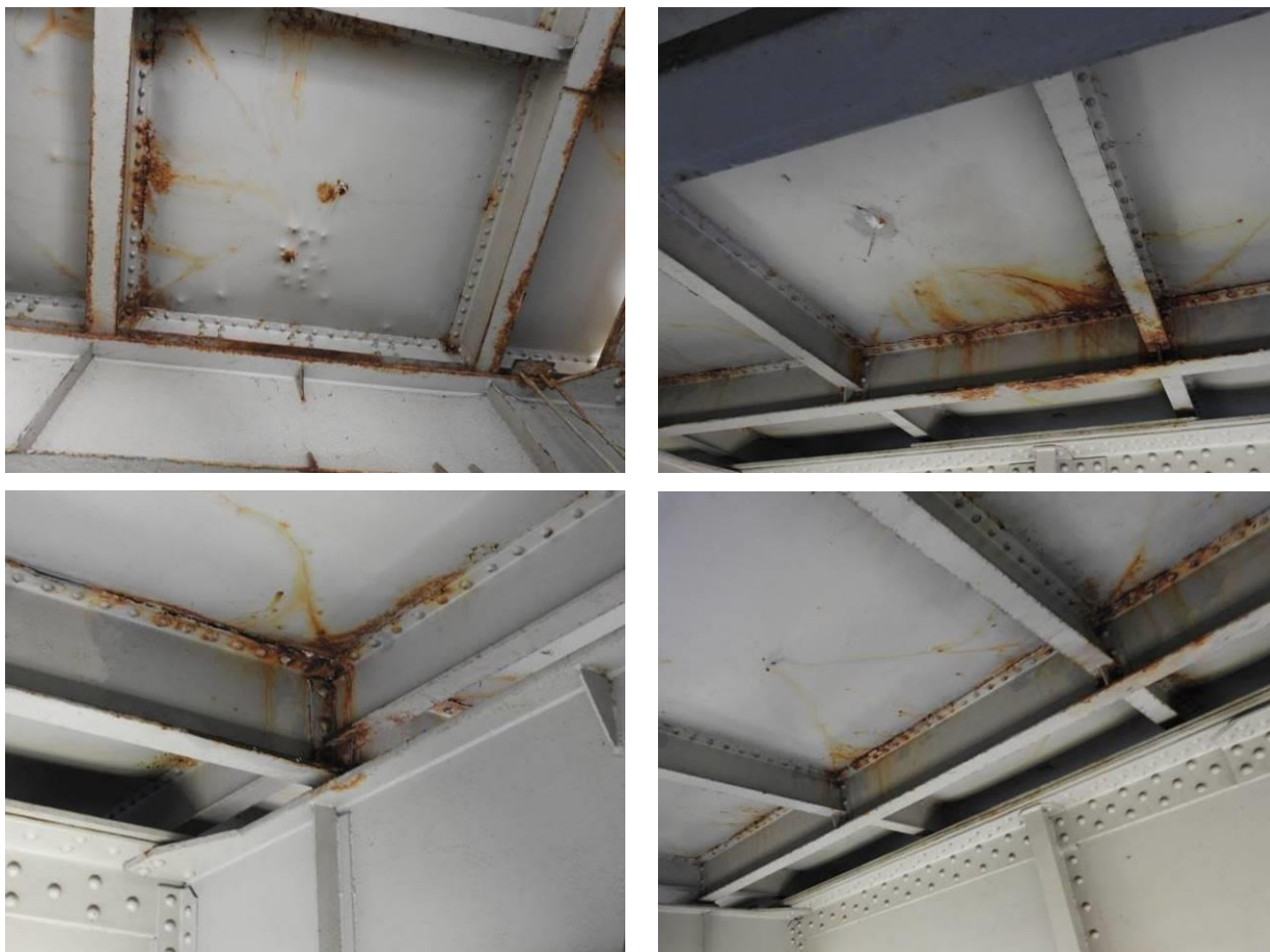
Fot. 3.16. Przykładowe fotografie przedstawiające stan techniczny izolacji na obiekcie.
