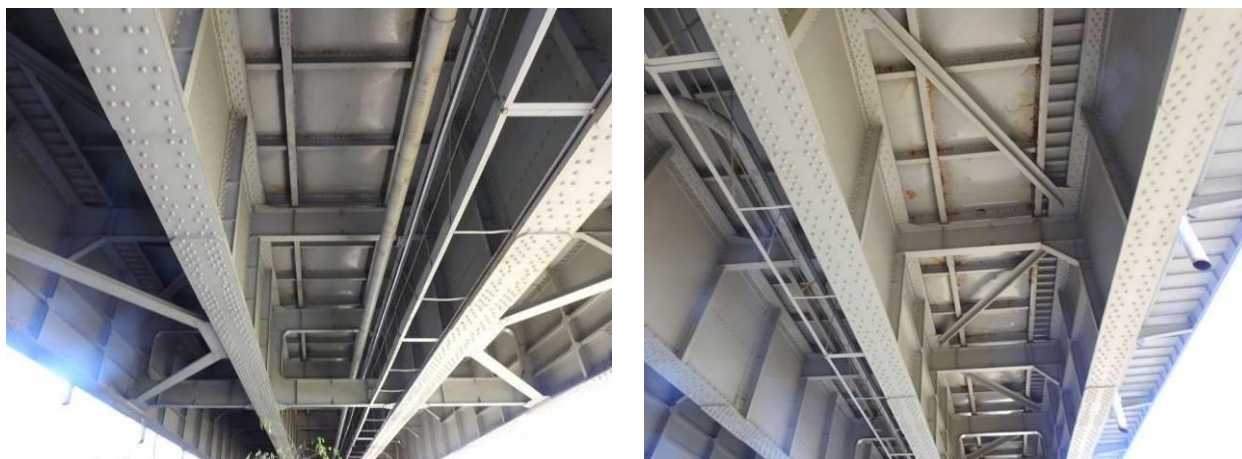
Fot. 3.20. Przykładowe fotografie przedstawiające stan techniczny ustroju nośnego mostu – dźwigarów blachownicowych, poprzecznic oraz stężeń podłużnych i poprzecznych.
