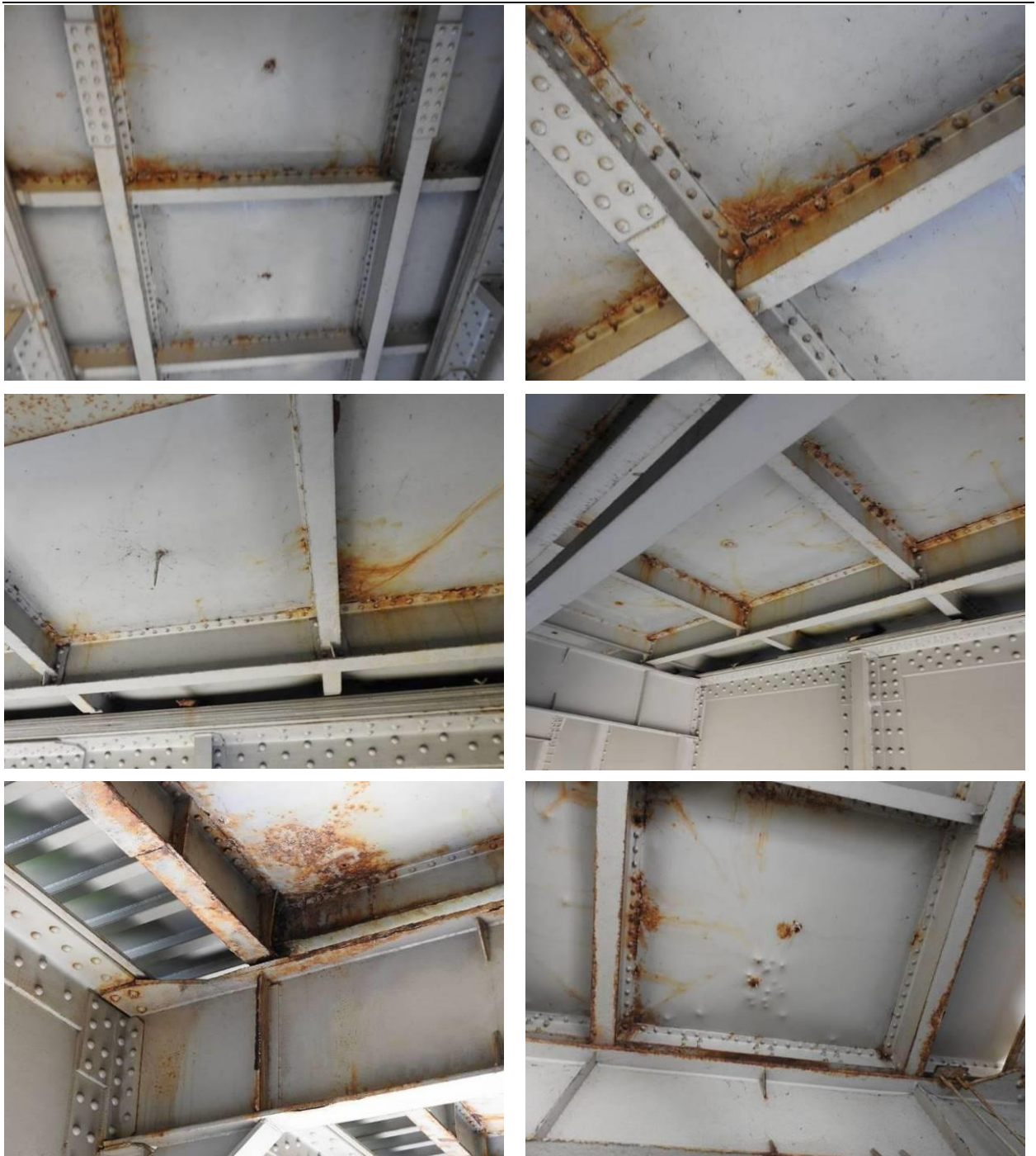
Fot. 3.19. Przykładowe fotografie przedstawiające stan techniczny pomostu – widoczne obszary uszkodzeń powłok antykorozyjnych z towarzyszącą im korozją powierzchniową, licznie występujące rdzawe zacieki, obszary zawilgoceń na powierzchniach blach nieckowych.
