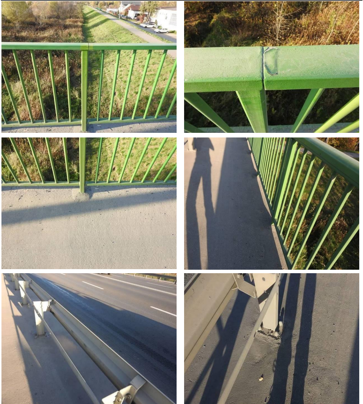
Fot. 3.10. Przykładowe fotografie przedstawiające stan techniczny balustrad i barier energochłonnej na obiekcie – widoczne drobne zanieczyszczenia powłok malarskich balustrad obniżające walory estetyczne, na całej długości balustrad po obu stronach obiektu występują niewielkie uszkodzenia zabezpieczeń antykorozyjnych oraz towarzysząca im korozja powierzchniowa oraz deformacje i zanieczyszczenia nawierzchni bitumicznej w miejscu kotwienia słupków bariery energochłonnej.
