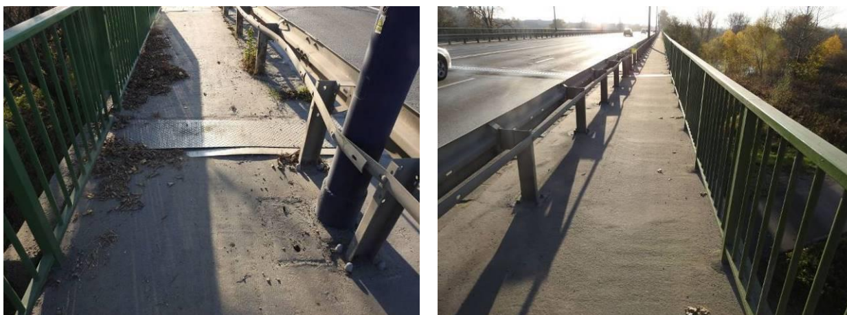
Fot. 3.5. Przykładowe fotografie przedstawiające stan techniczny chodników na obiekcie.
